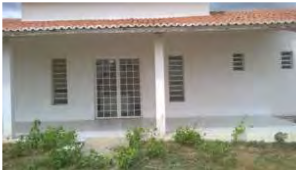
Figura 17: Detalhes da depredação de Posto de Saúde abandonado na cidade de Campos Sales, Ceará
